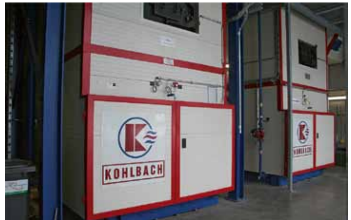
Zwei Kohlbach-Kessel aus Kärnten: Der Thermoölkessel Erna (li.) und der Warmwasserkessel Waltraud für die Wärme- und Stromproduktion
