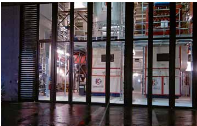
Vorzeige Biomasseheizkraftwerk: Naturwärme Montafon bei Nacht mit den beiden Kohlbach-Kesseln
